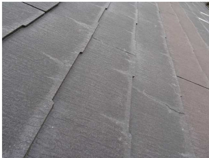
② 屋根全体に大小の亀裂が入っている
