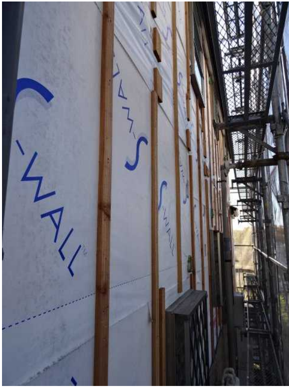
③ 既存サイディング撤去。防水シートや下地に問題なし。
